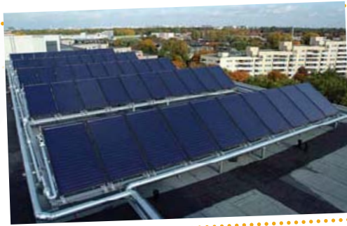
Sonnenkollektor auf einem Hausdach
