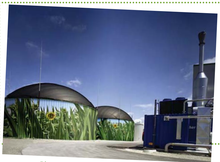
Bioreaktor (links) mit Kraftwerk (rechts)
